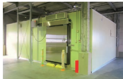
大型冷凍庫エリア
