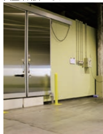
大型冷蔵庫エリア
