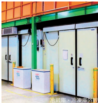
冷蔵庫・冷凍庫外観
